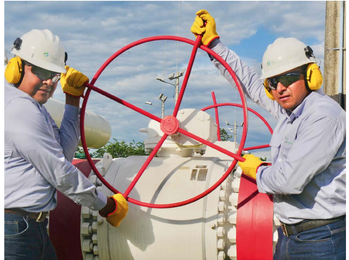
Colaboradores de TGI en la estación de compresión de gas en Mariquita (Tolima)
