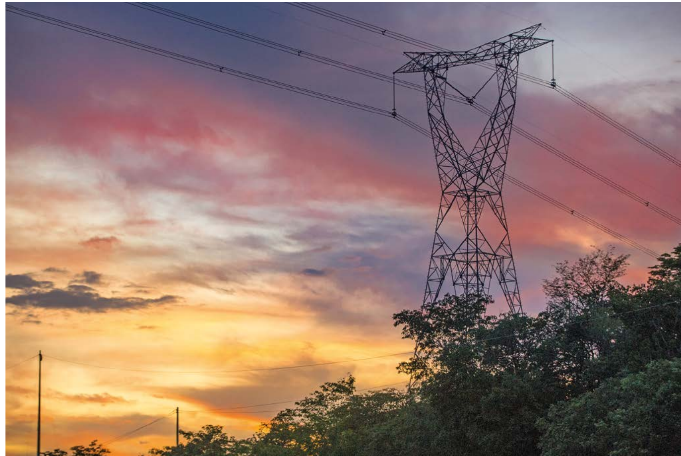
Torre en el corregimiento de La loma, Cesar
