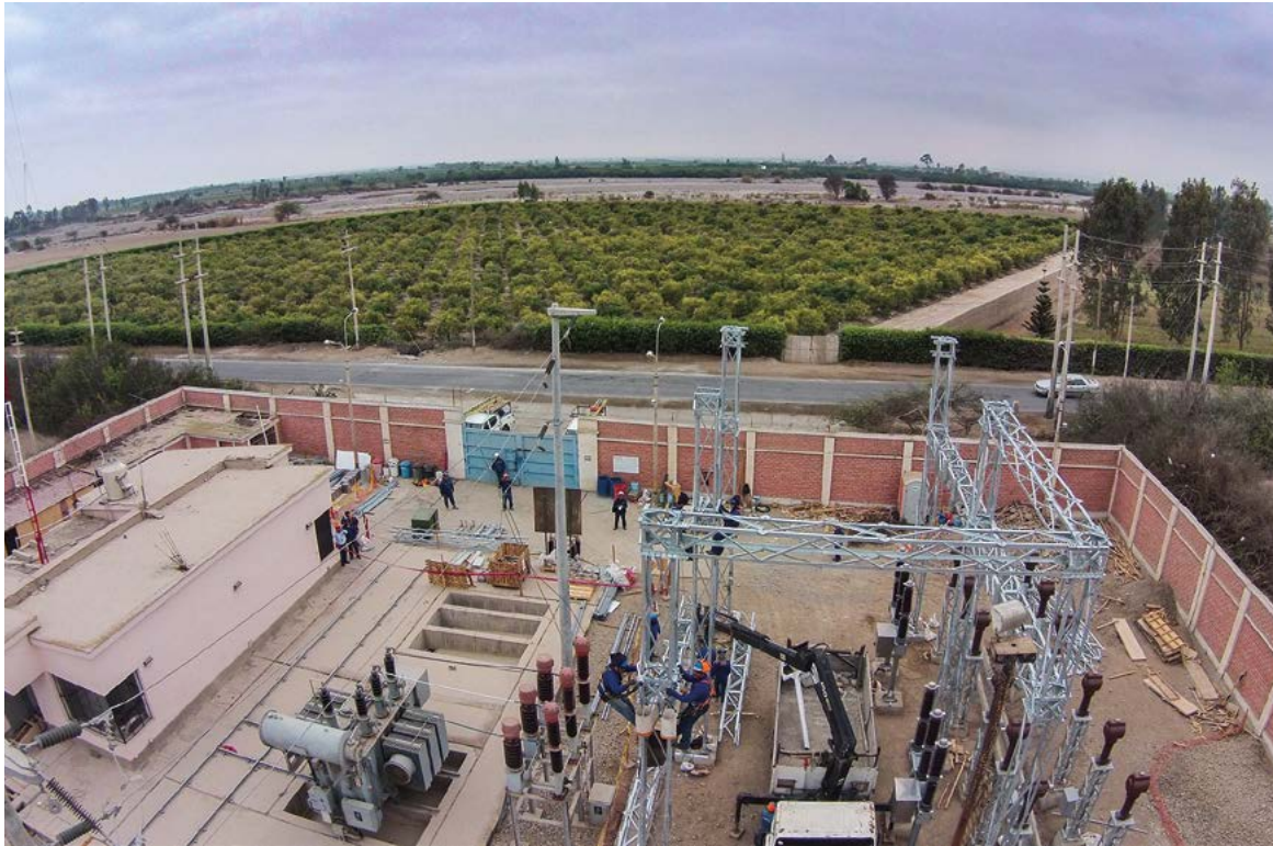
Infraestructura de Electro Dunas en Perú
